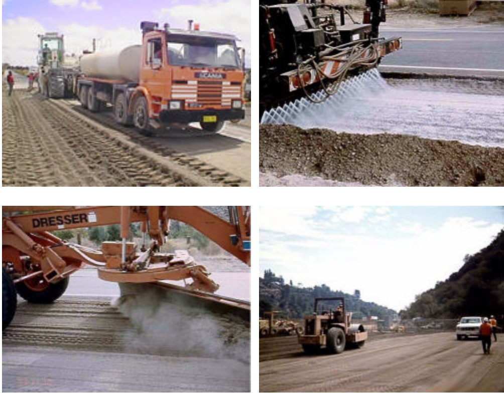
Figura I.2 Tendido, homogeneizado, compactado y afine de niveles para la construcción de la capa de base hidráulica.
