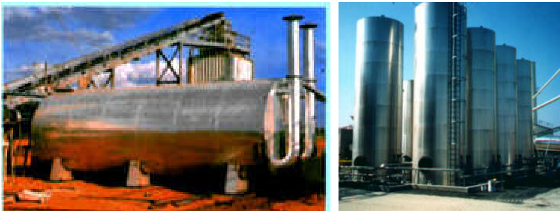
Figura J.3 Tanques típicos para el almacenamiento de materiales asfálticos.
