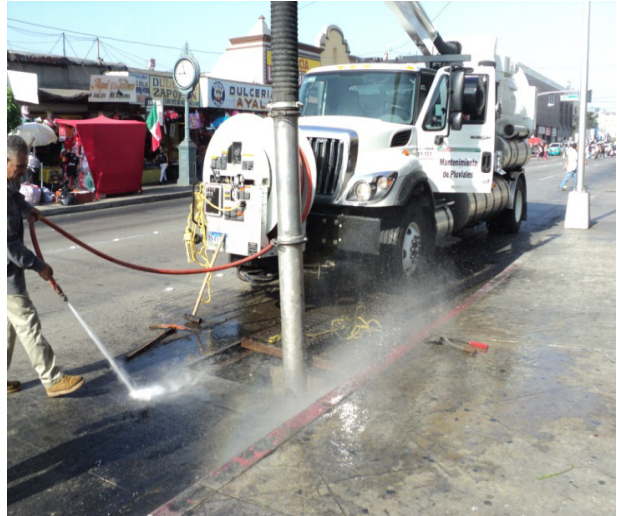
Equipo neumáticos para desazolve marca Vector
